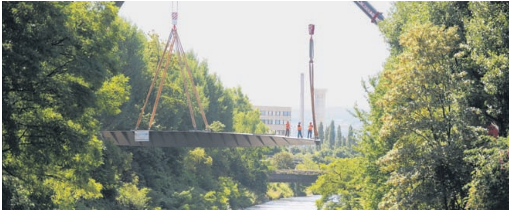
Kurz vor dem Ziel. Nach dreieinhalb Stunden Vorbereitung hoben zwei grosse Kräne die Stahlbrücke endlich in die Luft. Foto Pino Covino
